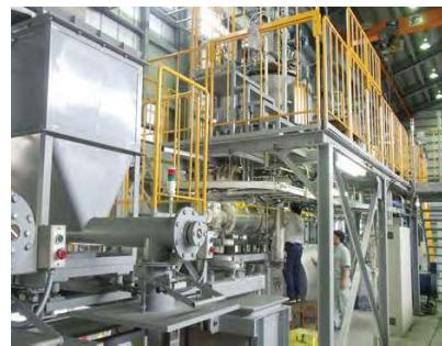
大木工藝さぬき工場 廃プラスチック・活性炭製造プラント
